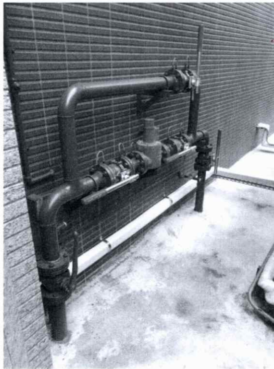
瓦斯站體位在車道出入口旁柵欄
